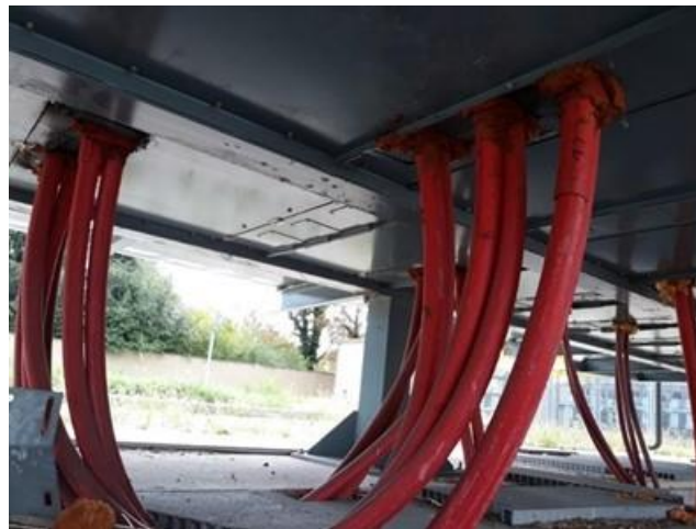
Figura 64 - Cabo MT para o contêiner
