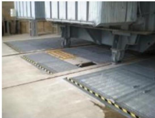
Figura 75 - Exemplo de poço individual ao redor do transformador
