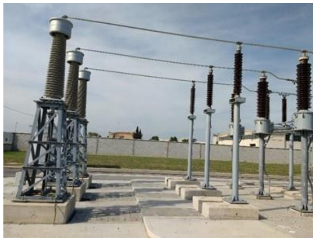
Figura 30 - Entrada da linha AT subterrânea
