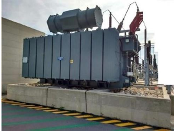
Figura 40 - Lado MT do transformador de potência
